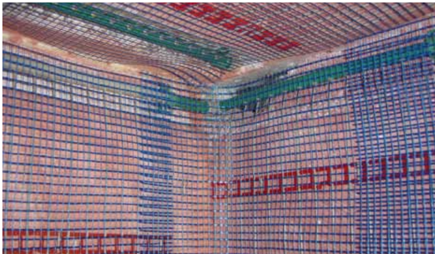
Pri celoplošnej inštalácii sa dosiahnu najnižšie možné prevádzkové teploty vykurovacej vody
