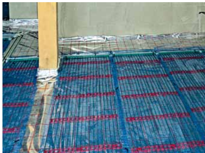
Obr. 10 Kapilárne rohože inštalované v podlahe, rodinný dom v Breze
