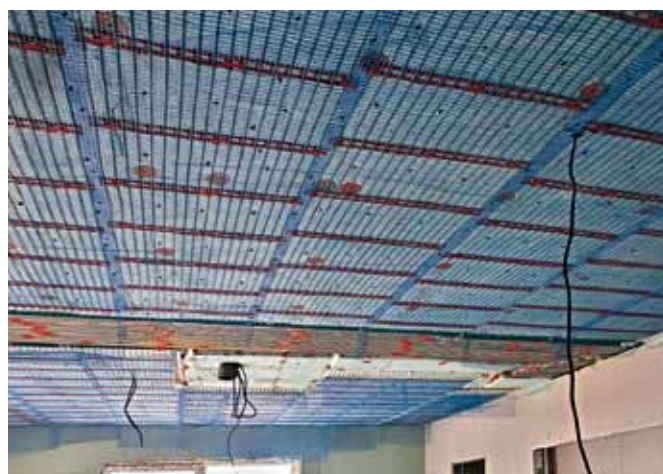
Obr. 12 Kapilárne rohože inštalované v strope, rodinný dom v Galante
