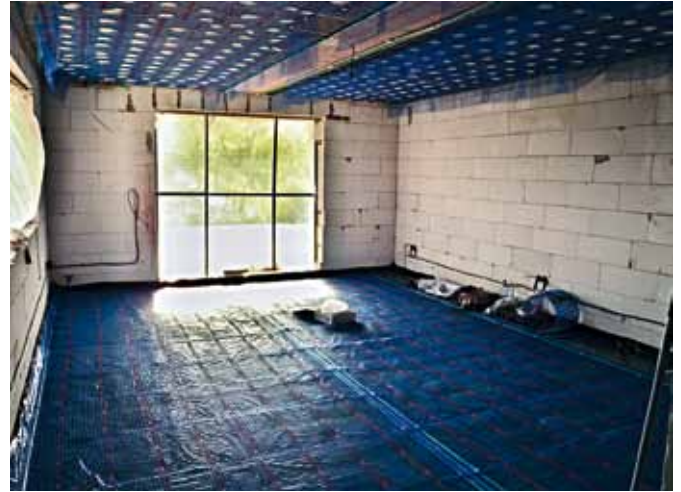
Obr. 8 Kapilárne rohože inštalované v podlahe a strope, rodinný dom v Námestove
