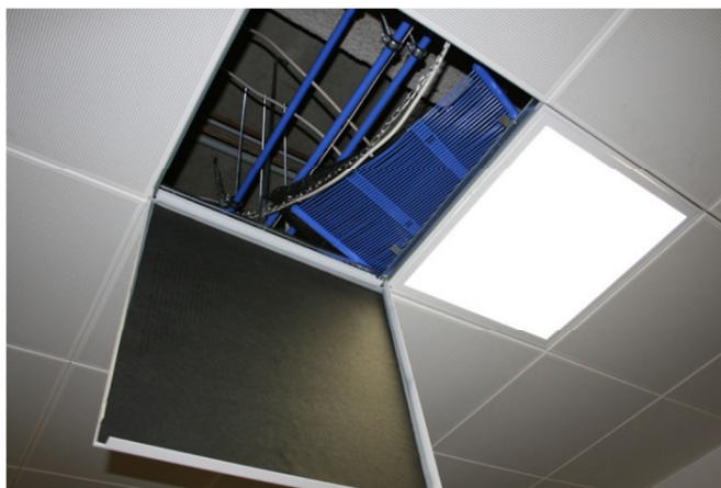
kovový kazetový strop s kapilárou ako chladiaci strop
